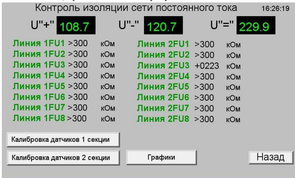
Рисунок 10. Снижение сопротивления изоляции на линии.
